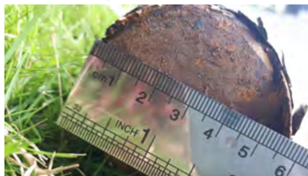
Gambar 3. Penampang Patahan Pipa Utama Portal yang Berkarat dengan Tebal < 1 Mm
