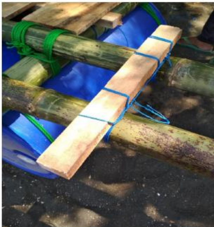
Gambar U Pemasangan alas kayu sebagai tumpuan papan kayu untuk orang jalan
